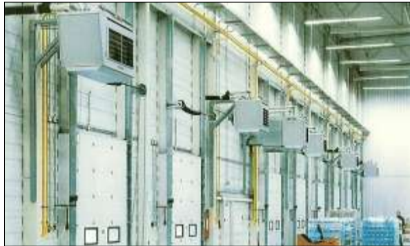
Vytápění výrobní haly teplovzdušnými plynovými jednotkami
