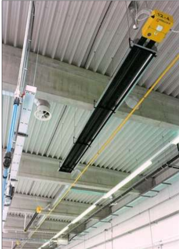
Vytápění výrobní haly tmavými infračervenými plynovými zářiči
