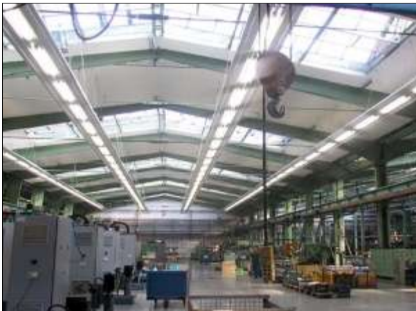
Vytápění zavěšenými sálavými panely v kombinaci s osvětlením
