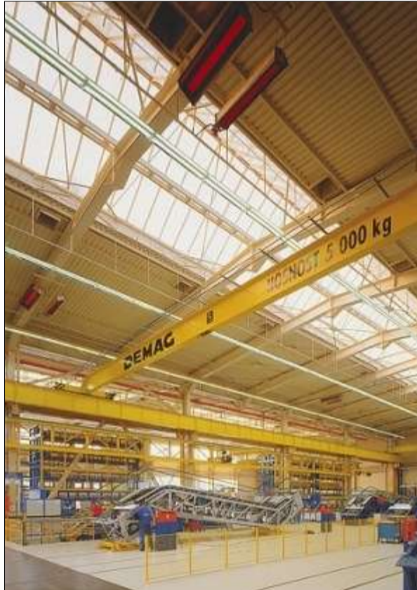
Vytápění výrobní haly světlými infračervenými plynovými zářiči
