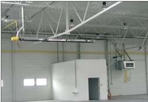
Kombinace vytápění tmavými infračervenými zářiči a teplovzdušnými jednotkami
