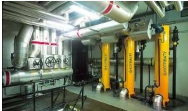
Výměňková stanice pára-voda s uzavřeným parokondenzátním okruhem
