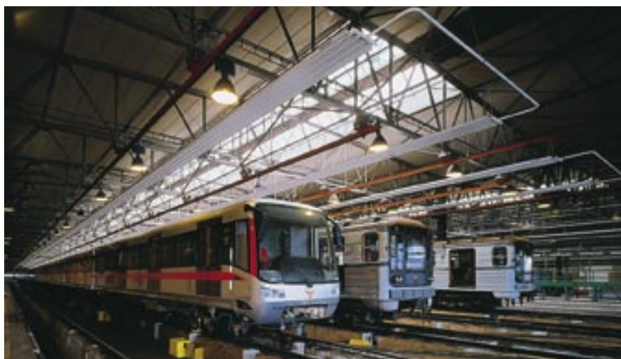
Sálavé panely umístěné v depu pražského metra
