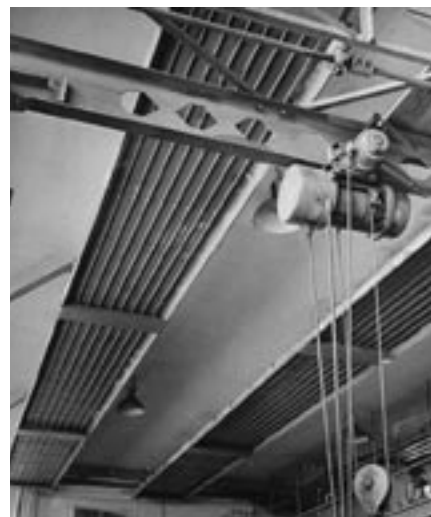
První sálavé panely (vodní) v loděnicích v Praze (1954)
