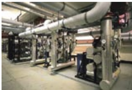
Výměňíková stanice voda-voda (vlevo) a pára-voda (vpravo)
